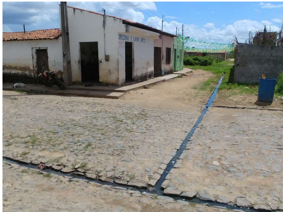
Vista do esgoto a céu aberto na área não atendida pela rede coletora
