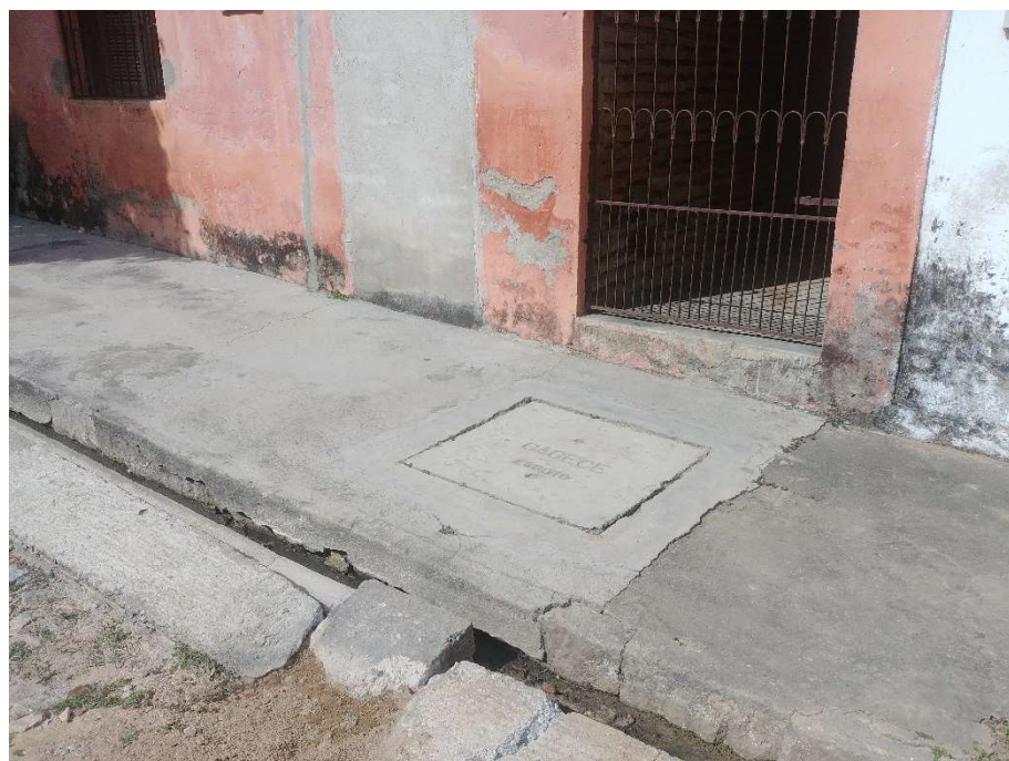
Vista da caixa de ligação predial na área em execução do sistema de esgotamento
